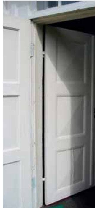
7.2.9: Inngangsparti med tofløyet fyllingsdør og overlysvinduer i den gamle hovedbygningen på Nesoddtangen gård. Foto: Akershus fylkeskommune
