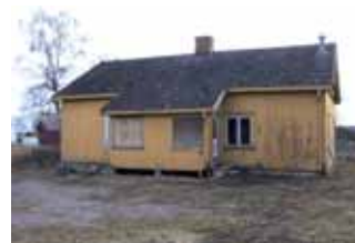
7.2.11: Dragvoll vokterbolig på Hovedbanen ble vedtatt fredet i 1998. Bildet viser bygningen i 2002 før den ble istandsatt. Foto: Akershus fylkeskommune
