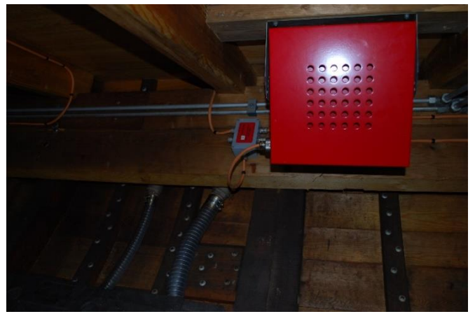
Brannslukkeranlegg - røyk- og pulverbasert.
