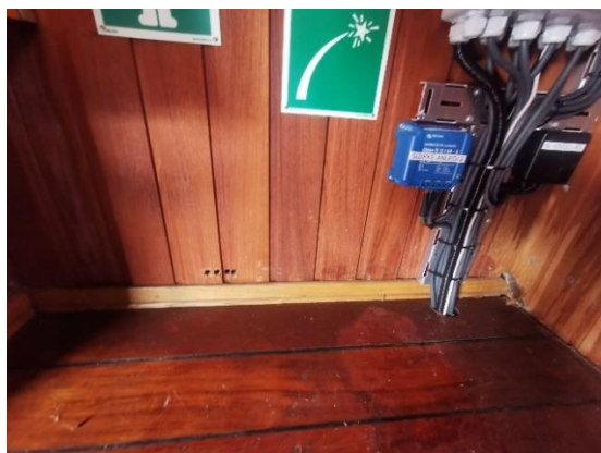
Gulvlister og elanlegg til brannslukningsanlegget.
