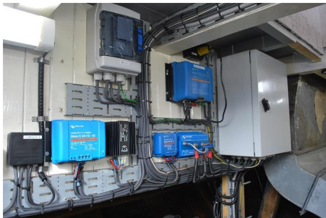
El-tavler og sikringsskap.
