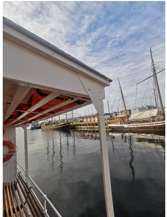
Stender takoverbygg med stålprofil, BB-side.
