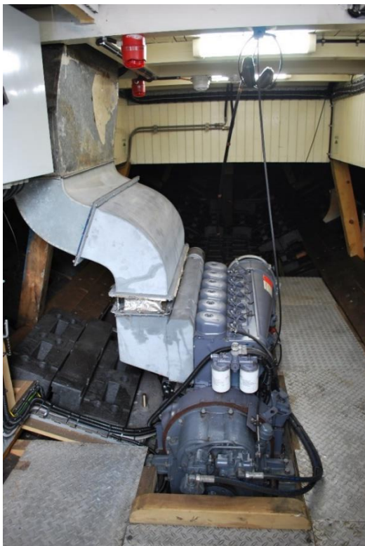
Motor med eksos/kjøleluftkanal.
