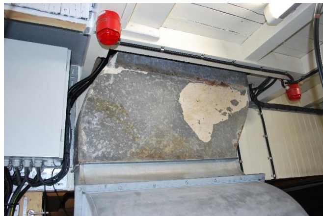
Eksos/kjøleluftkanal ved skylight.
