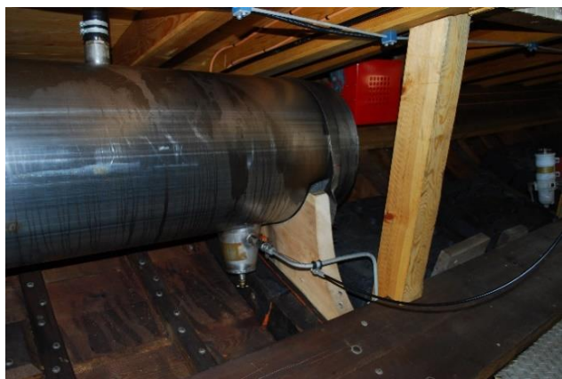
Dieseltank - dieselryr. Tanken er bunkers. Kopi i form av den opprinnelige, men laget i syrefast og i tykker gods i forbindelse med restaureringen 2015-2023.
