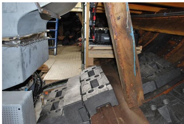
Eksos/kjøleluftkanal og ballast.
