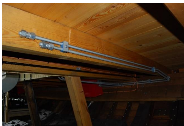
Hydraulikkrør til styringssystemet.
