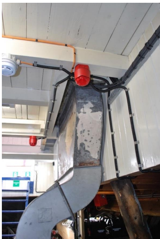
Eksos/kjøleluftkanal. Denne ble endret i 1970. Tidligere hadde «balja» skorstein.
