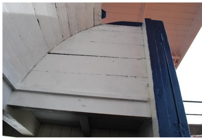
Nedgangskappe SB-side. Opprinnelig kledning.
