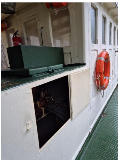
Inspeksjonsluke kjele, styrbord side.
