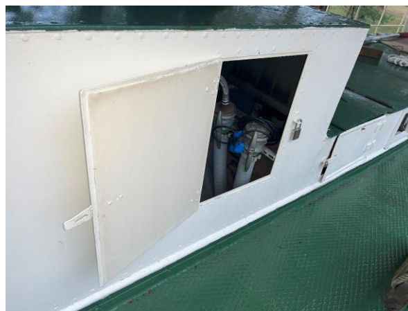
Inspeksjonsluke til kjeletopp, babord side.
