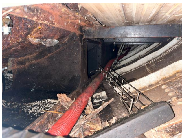
Rista under/ved kjelen.
