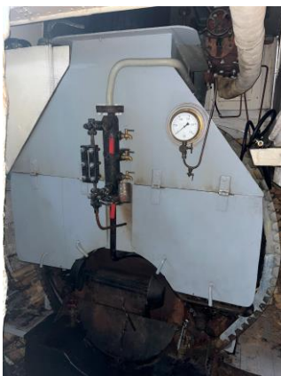
Røykkasse/fyrkasse, «kjerka» med vannstandsmåler. Manuell målig med tre kraner og vannstandsglass. Trykkmåler for kjeletrykket til høyre.
