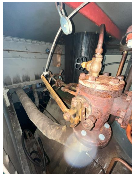
Kraner for styring til for fløyte, injektor, hoveddamp og vannpåfylling. Wire til nødstop av hoveddamp.
