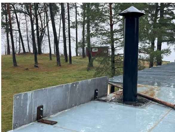
Rørgjennomføring, vedkomfyr i byssa. Baksiden av navneskiltet, styrbord.
