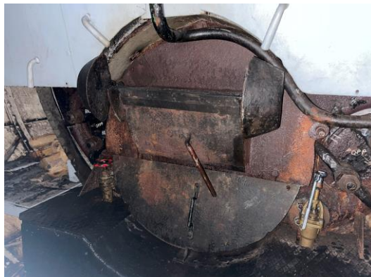
Kjeleluke øverst, trekkluke nede. Kraner på hver side som regulerer vannsirkulasjonen i kjelen.
