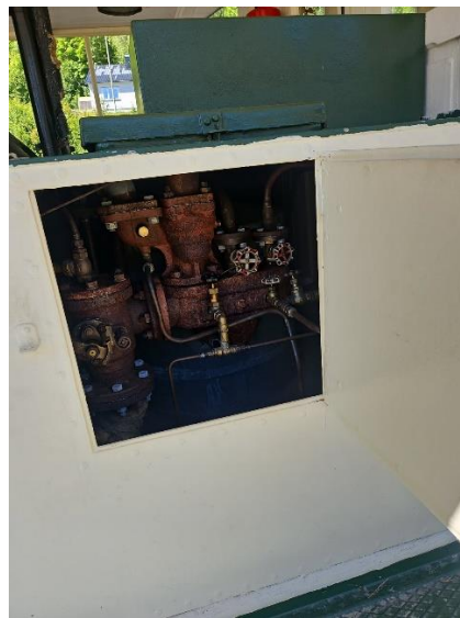
Inspeksjonsluke til nødventil i maskinrommet.
