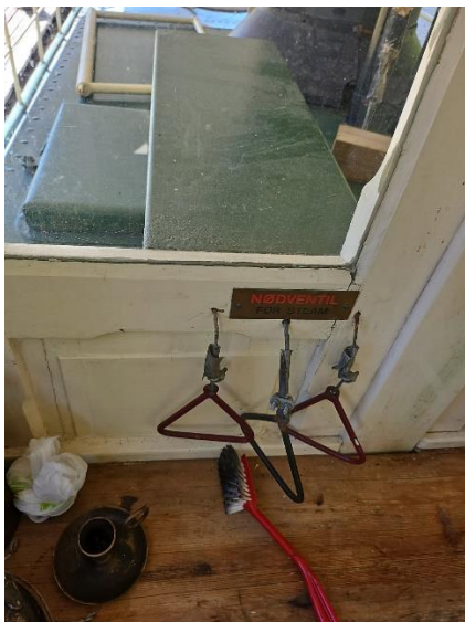
Wirere/systemet som utløser nødventil i maskinrommet fra styrhus.
