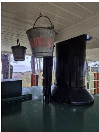
Gjennomføring skorstein – kjele casing.
