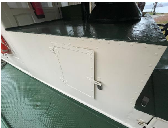
Inspeksjonsluke til kjeletopp, babord side.
