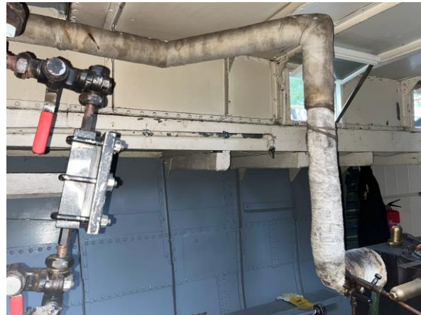
Vannstandsglasset til venstre i bildet.
