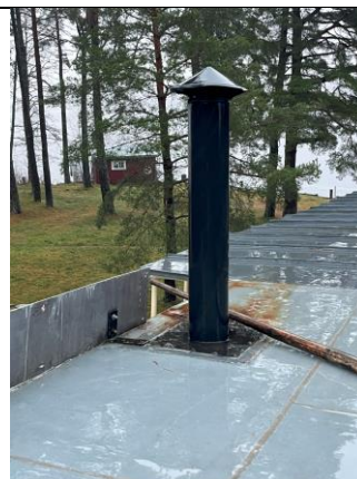
Rørgjennomføring, vedkomfyr i byssa. Baksiden av navneskiltet, styrbord.
