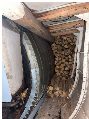
Styrbord vedlager – ved kjelen.
