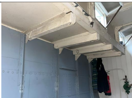
Støtteknær til dekk og lysventiler. Til høyre står hånddrevet lenseapparat.
