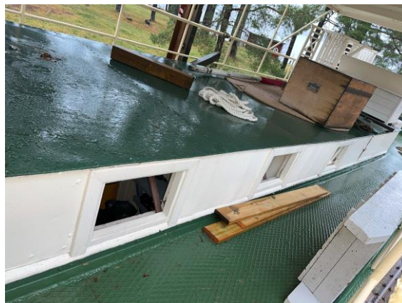
Casing og lysventiler, babord side.
