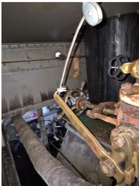
Kraner for styring til for fløyte, injektor, hoveddamp og vannpåfylling.
