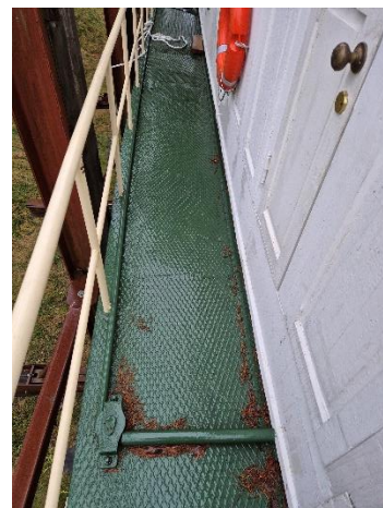
Rifledekk, rørgjennomføring for kjettingsstyring.
