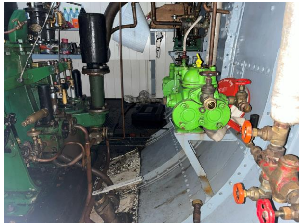
Eksternt brannslukningsapparat i midten. Eksternt tilkoplet. Injektorapparat til høyre hjørnet.
