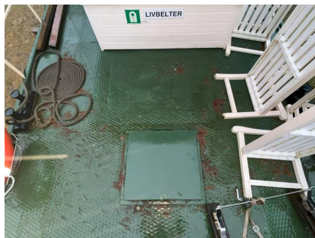
Nedgangskappe rørtunnel, livbeltekaske mm.
