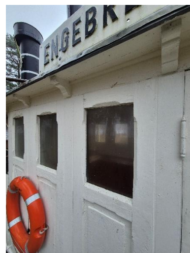
Vinduer/lysventiler styrhus, styrbord side.
