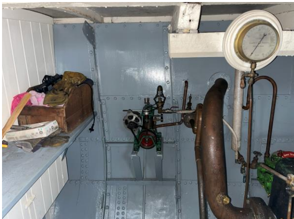
Ekstern dynamo til strøm om bord, Ikke i bruk, men er i orden. Det store røret er kjølevannsrøret. Babord side.
