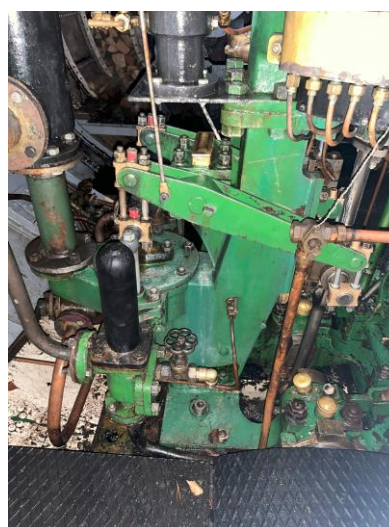
Smøreboks opp til høyre, kontrollkran til kjølevannsavløpet. Til venstre står tre pumper på rekke og rad – lensepumpe, vakuumpumpe og innerst fødepumpe. Akkumulator i svart.
