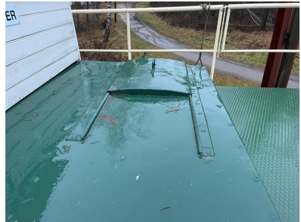
Skyvedør til åpning av nedgangskappe, mannskapslugar. Styrbord side.
